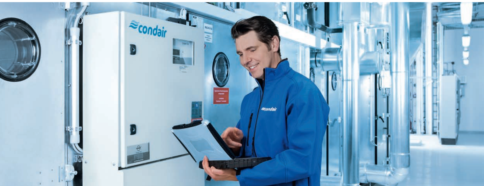
Condair Dual in einer RLT-Anlage
