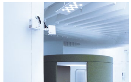
Das Luftbefeuchtungssystem DRAABE NanoFog Evolution im Fraunhofer IAO
